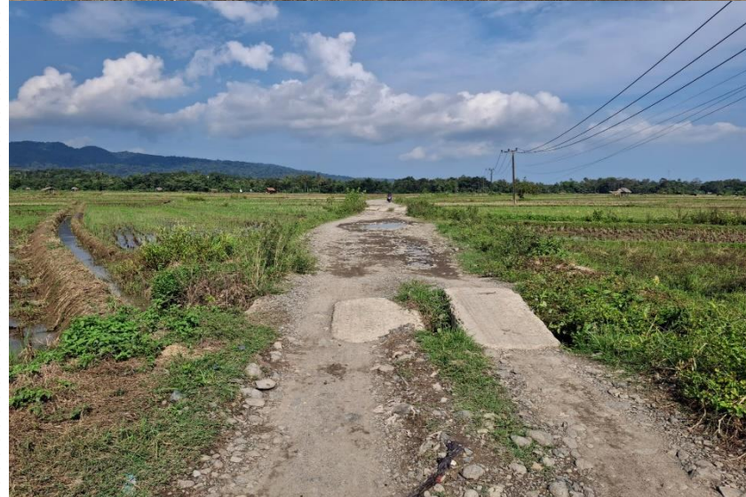
Survey Kelengkapan Jalan Menggunakan Mobil Hawkeye Ruas Jalan No 86 Sumur – Ujung Jaya
